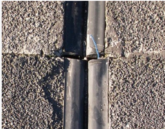
Openstaande stortnaad / niet ge vulkaniseerde voegprofiel delen
