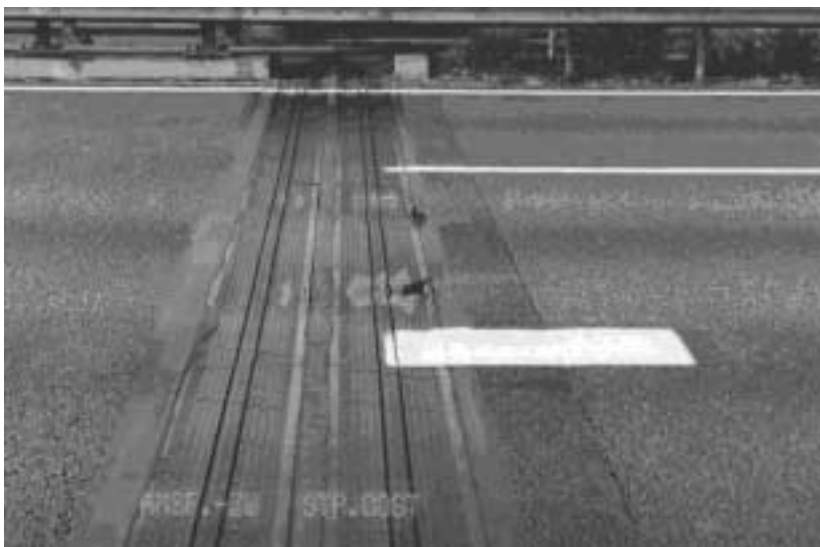
Afbeelding 2. Zwaar beschadigde rubberband bij een z.g. STOG voegovergangsconstructie
