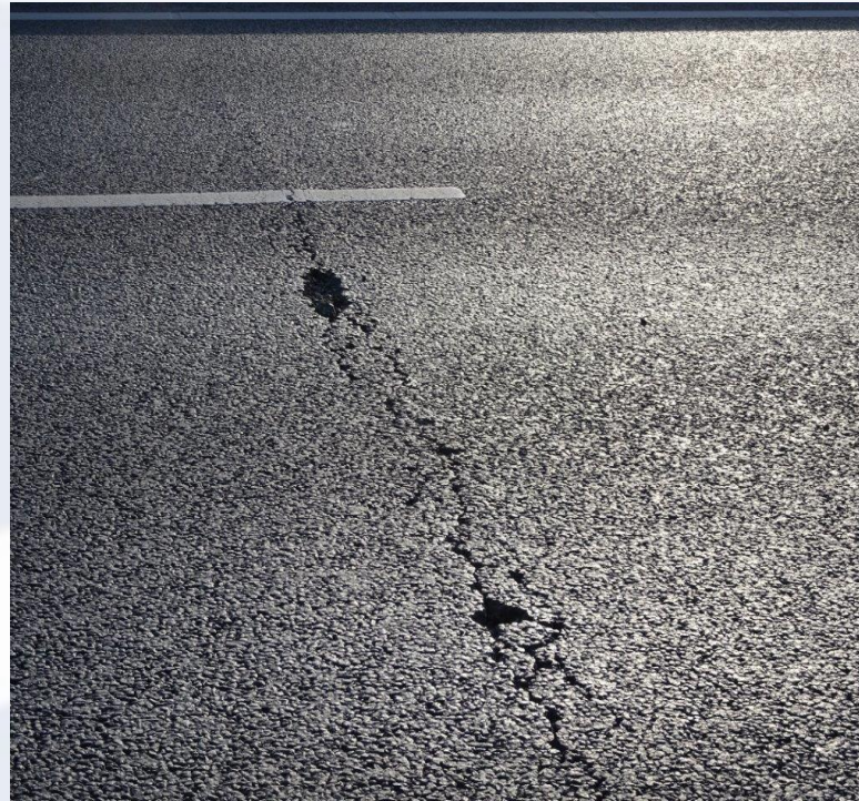
Scheurvorming -> lekkage, gaten
