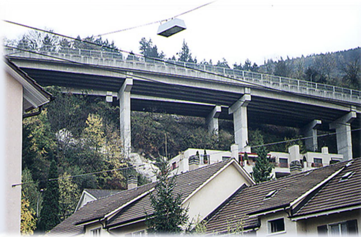
Bözinger Viaduct bij Biel in Zwitserland 75 mm horizontale beweging
