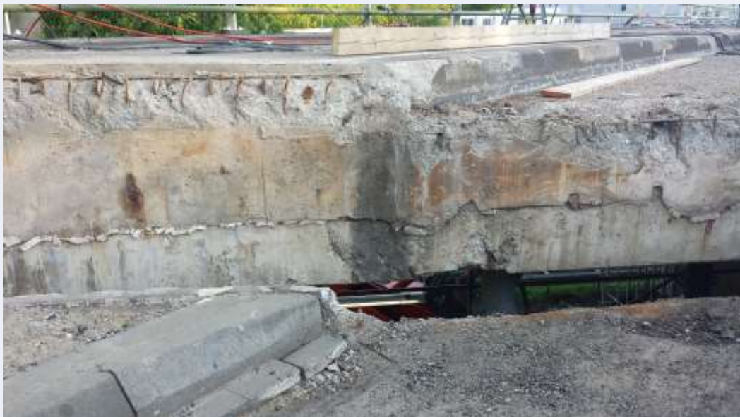
Verankeringszone voorspanning in gevaar
