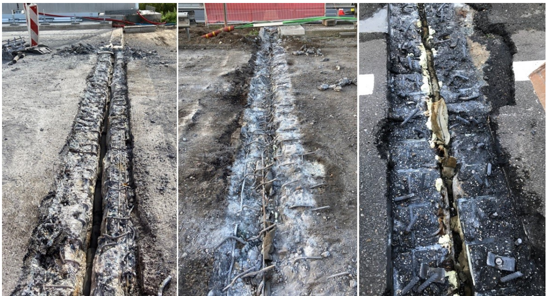
Figuur 5-1 Sloopschade en aantasting
