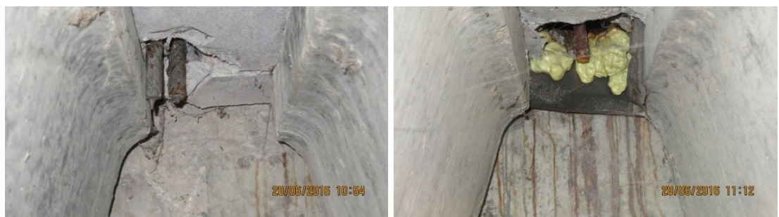
Figuur 6-13 Beschadigde druklaag
